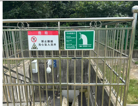
厂区污水总排口
