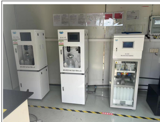
厂区现有工程废水在线监测
