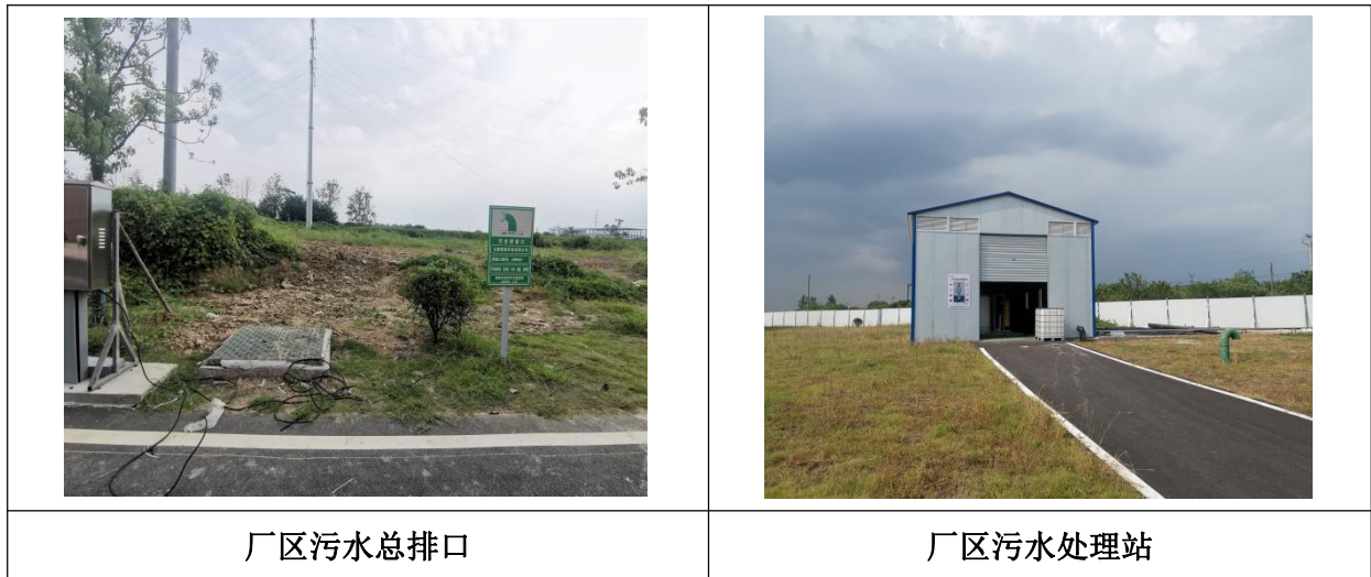
图 5.2-2 本项目废水污染治理设施图
