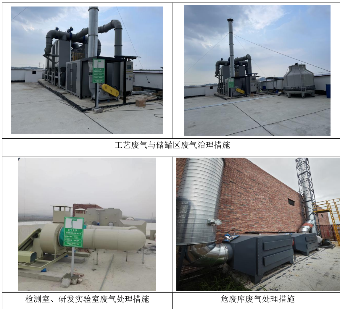
图 5.1-2 本项目大气污染治理设施图
